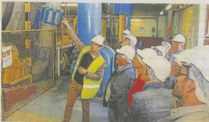
Les élus du Sittom-mi devant la cuve oscillante dans laquelle sont incinérés les déchets ménagers.
